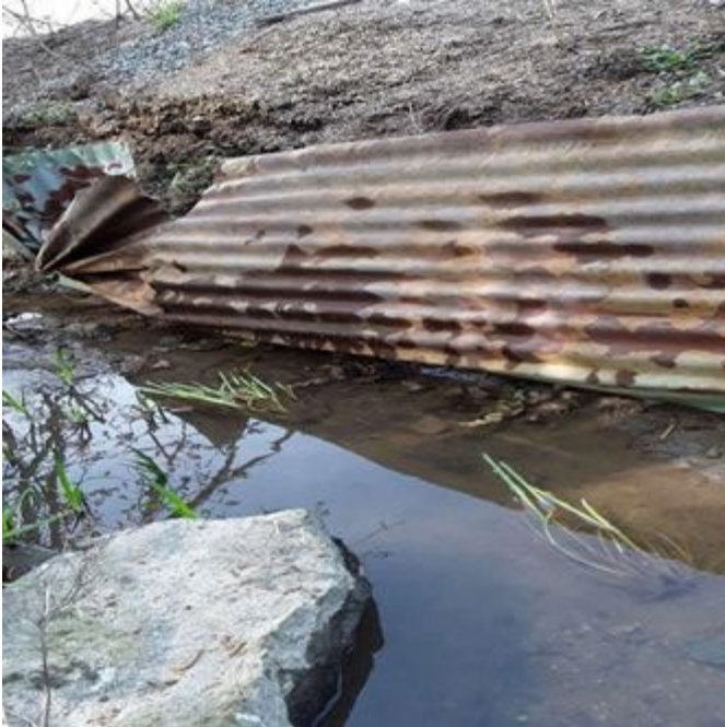
M1 avfall i bekk
