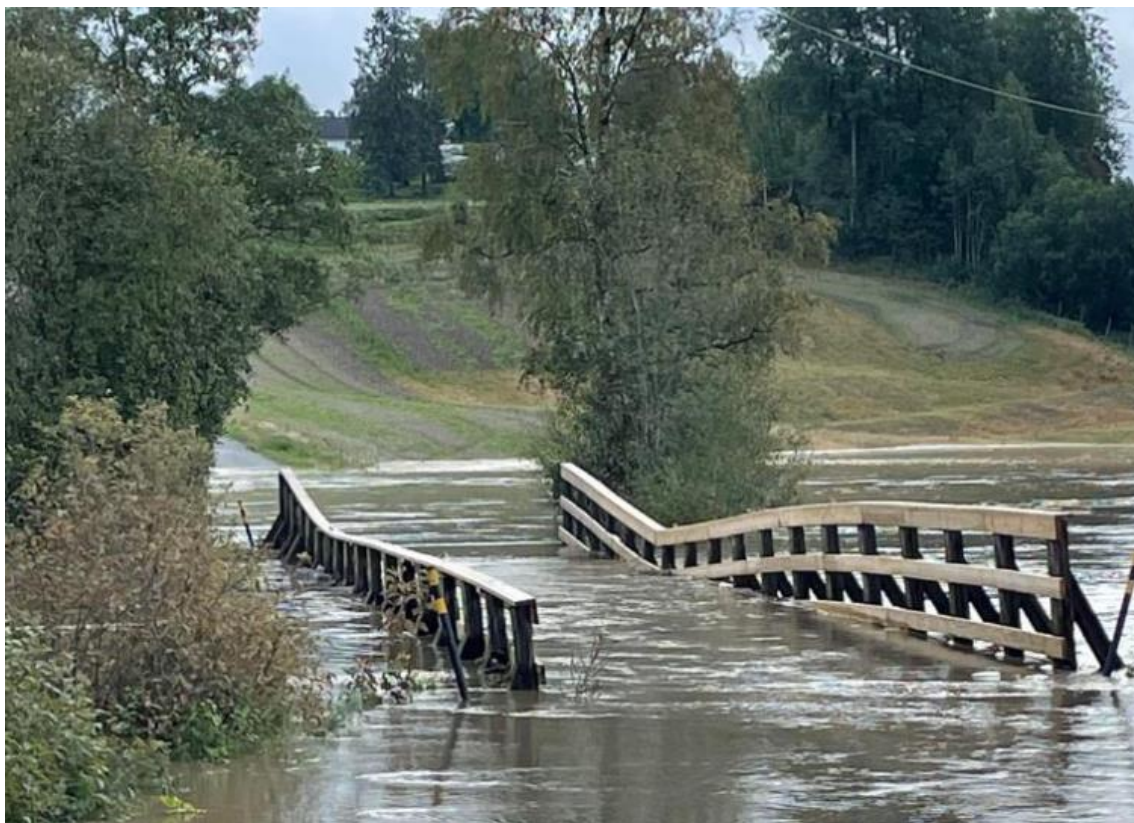
Figur 7: Riiser bru under flom høsten 2023 (Foto: Indre Østfold kommune).
