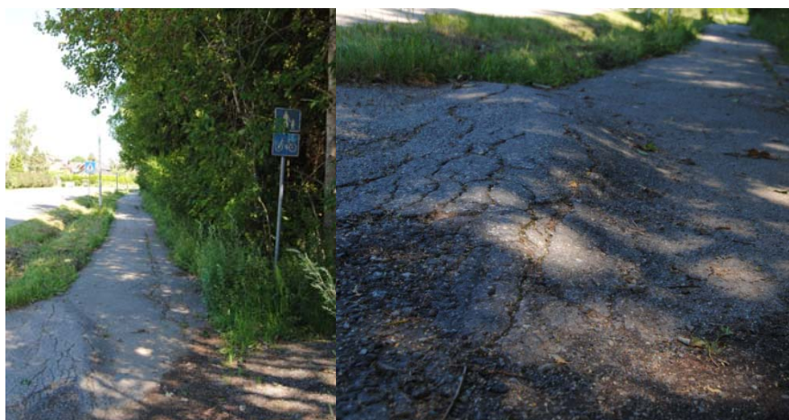
Figur 16 Gang- og sykkelveg på strekning 5.3 bør utbedres med nytt vegdekke.
