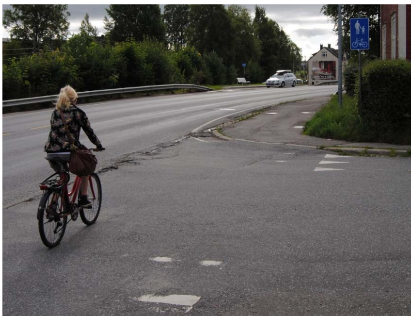
Figur 10 På strekning 1.1 trenger oppmerkingen av gang- og sykkelvegen vedlikehold (ved avkjørsel til bensinstasjon).
