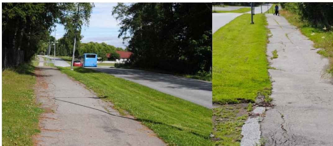
Figur 13 Strekning 3.2 trenger vedlikehold og bør reasfalteres
