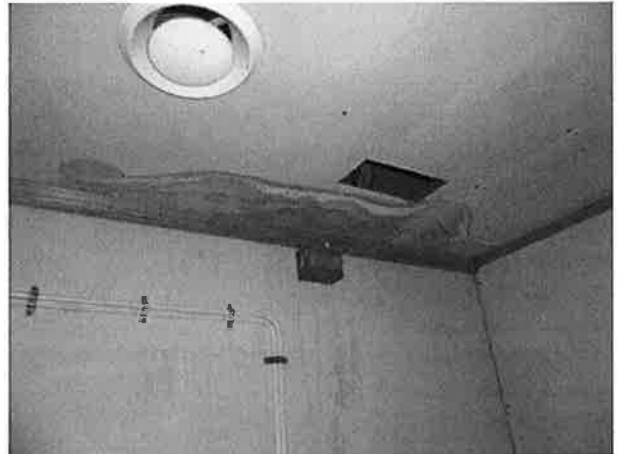
B34 Vannskade rom B020 Keramikkovn.
