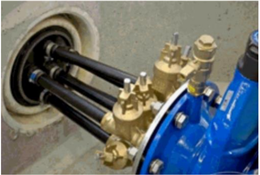
Figur 10. Eksempel på stikkledninger som ligger buntet sammen
