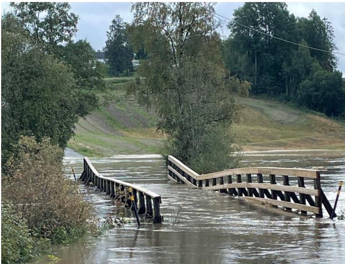
Figur 1-1. Riiser bru under flom høsten 2023 (Foto: Indre Østfold kommune)
