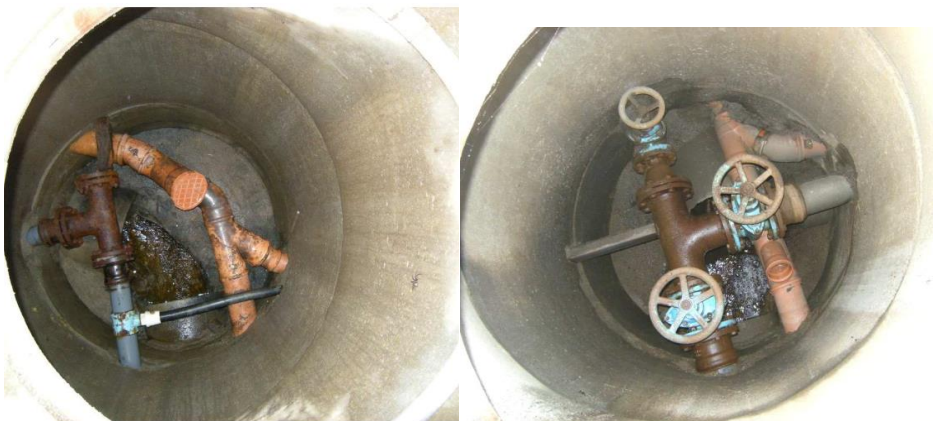
Figur 3: Kum SID 1718 (venstre) og kum SID 129782 (høyre), felleskum som inneholder vannledning øverst, spillvannsledning (oransje) i midten og overvannsledning nederst. Utklipp fra kumkort mottatt fra kommunen.
