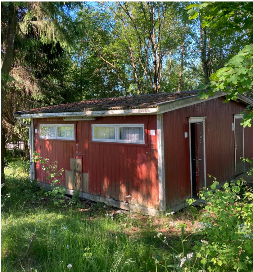
Campinghyttene med tilhørende støttebygninger er i til dels dårlig forfatning.
